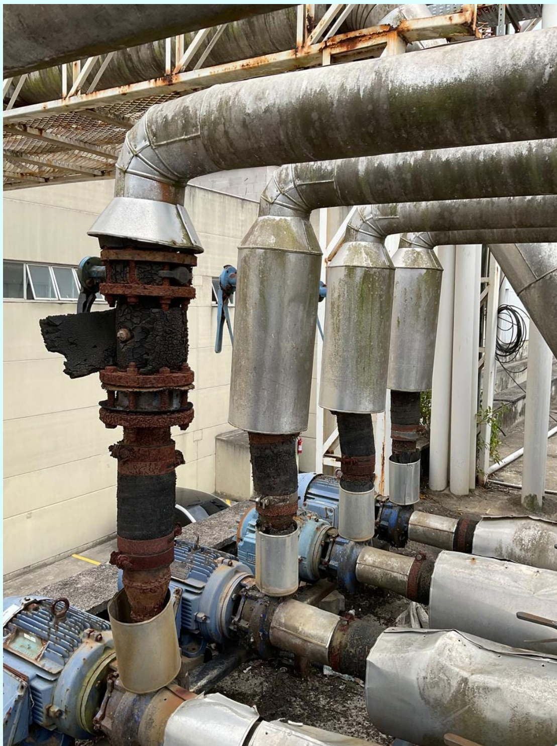
Imagem 4 – Conjunto de bombas
