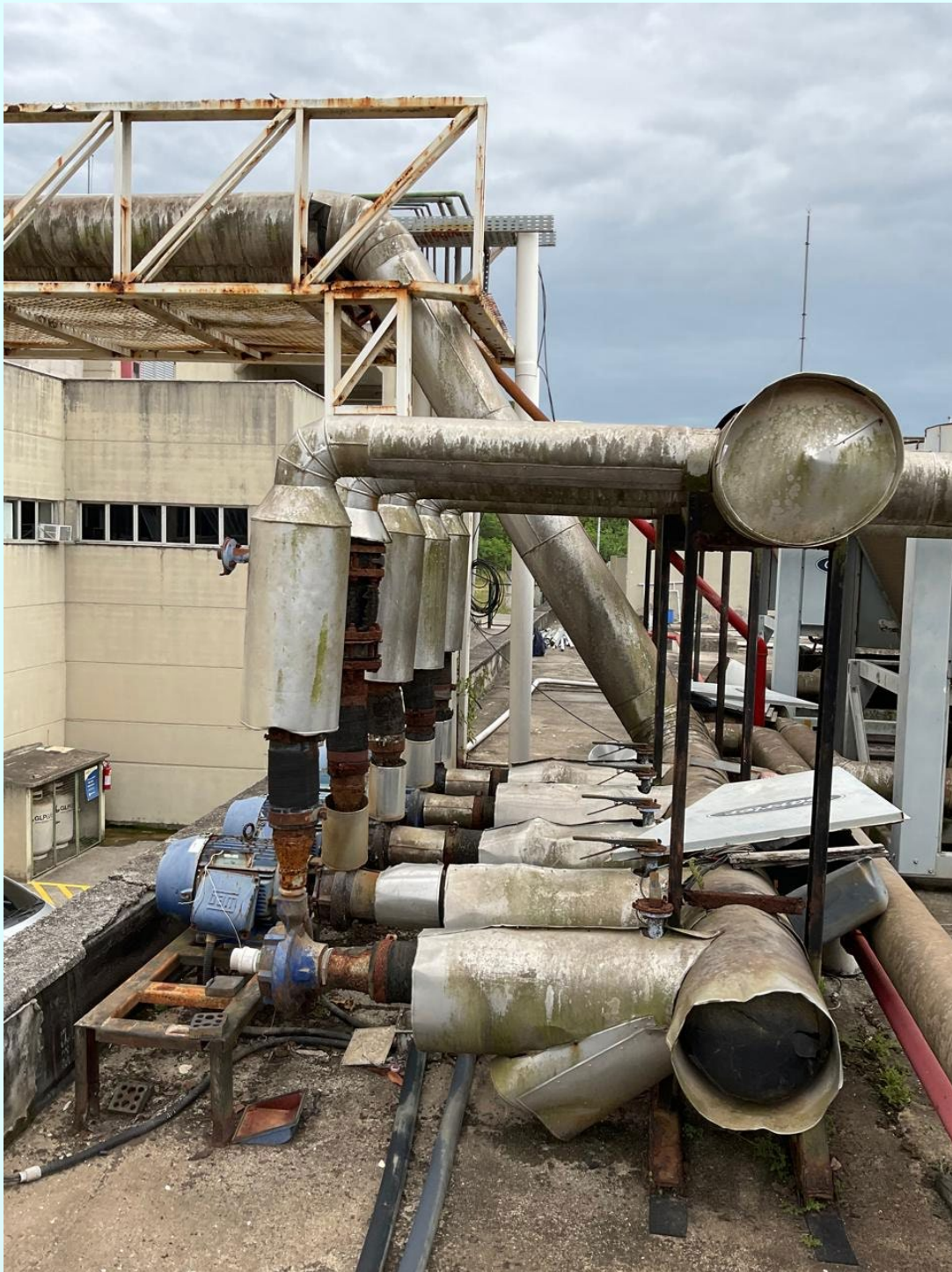
Imagem 5 – Conjunto de bombas e barriletes
