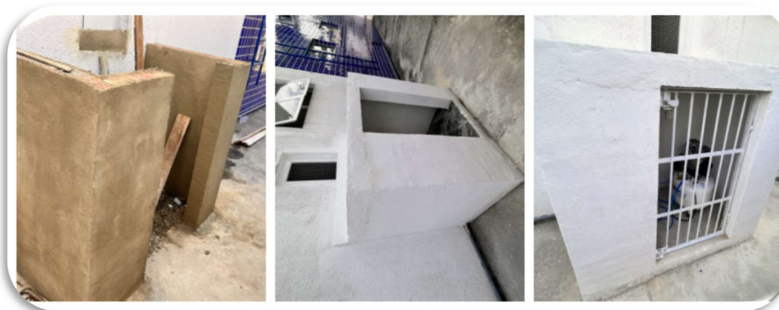
Instalação para abrigar o compressor – Clínica da Família Edi Pinto
